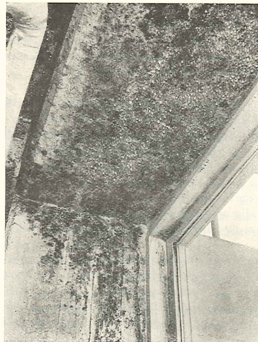
Fig. 38. Kuldebro over vindue i et lokale med høj luftfugtighed.
